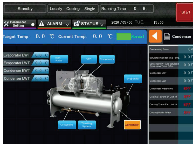
Рисунок 2.6. [Главный экран] — [Конденсатор] Экран просмотра состояния (у различных устройств может отличаться)
